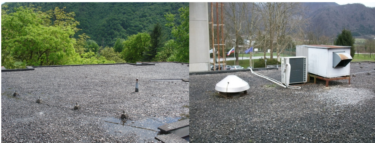
Slika 3: Ravna streha v slabem stanju ter s poddimenzionirano toplotno izolacijo
